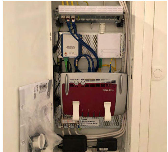
Abbildung 31: Beispiel eines beschalteten Multimediaverteilers mit GF-TA und SpeedNet Rohr. Quelle: NY-NEX/fiberONE
