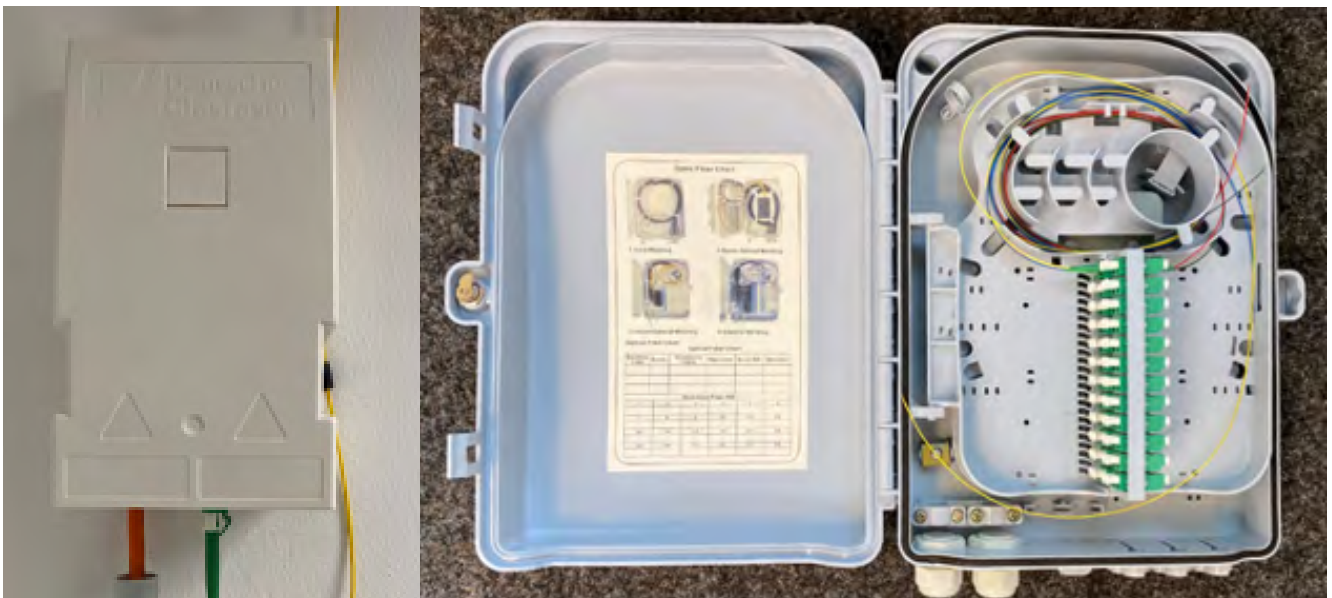
Abbildung 20: Beispiel eines Glasfaser-Abschlusspunktes (Gf-AP). Quelle: Deutsche Glasfaser
