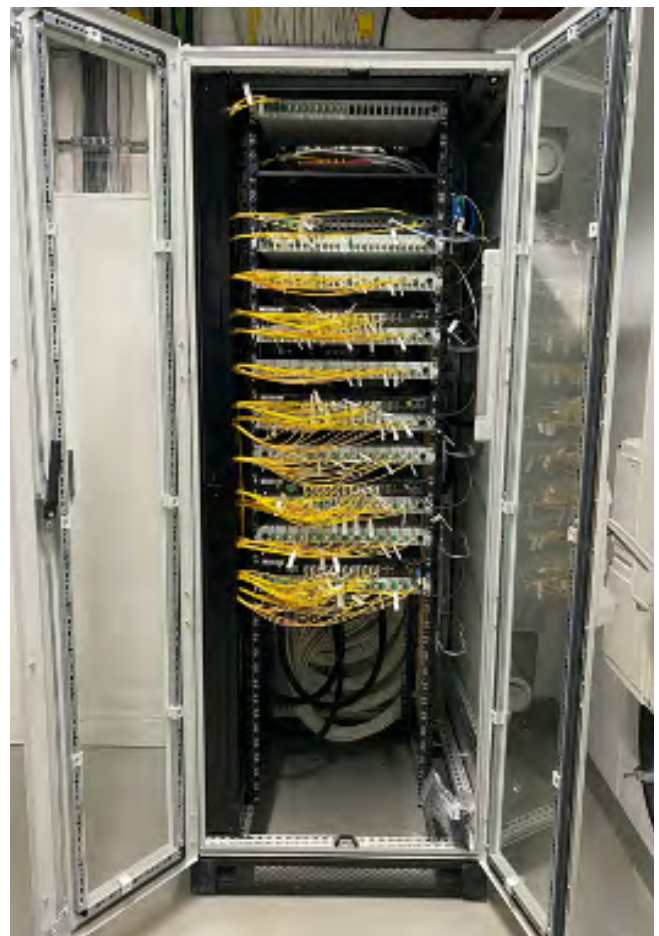
Abbildung 23: 19" Netzwerkschrank mit 42 Höheneinheiten und vertikalem Kabelmanagement System auf der linken Seite als Gf-GV für 108 Wohnungen (je 4 Fasern). Quelle: NYNEX/fiberONE
