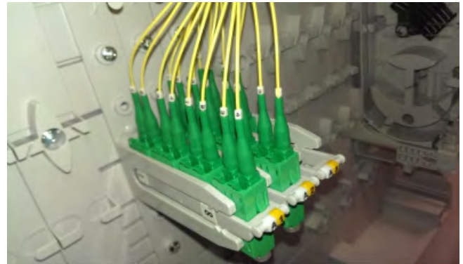
Abbildung 22: Beispiel einer übersichtlichen Steckerablage im Glasfaser-Gebäudeverteiler (Gf-GV). Quelle: Deutsche Telekom
